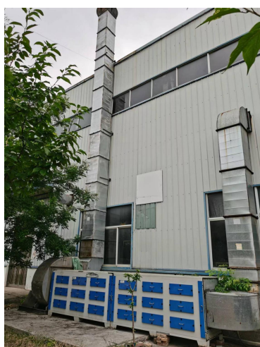
印刷废气处理设施及排气筒
