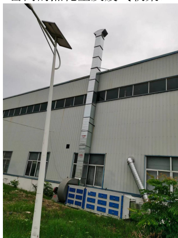
2#复合废气处理设施及排气筒
