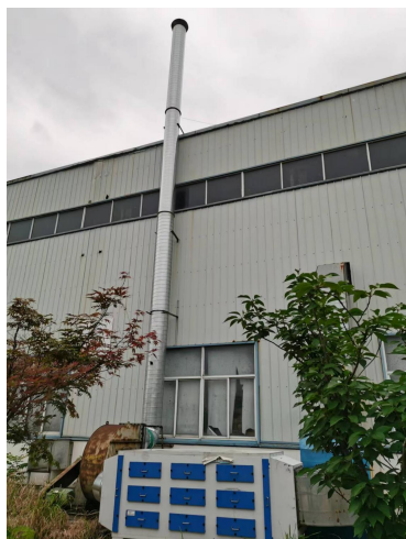
1#复合废气处理设施及排气筒
