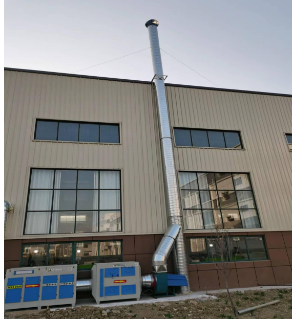
熔融挤出工序废气处理装置
