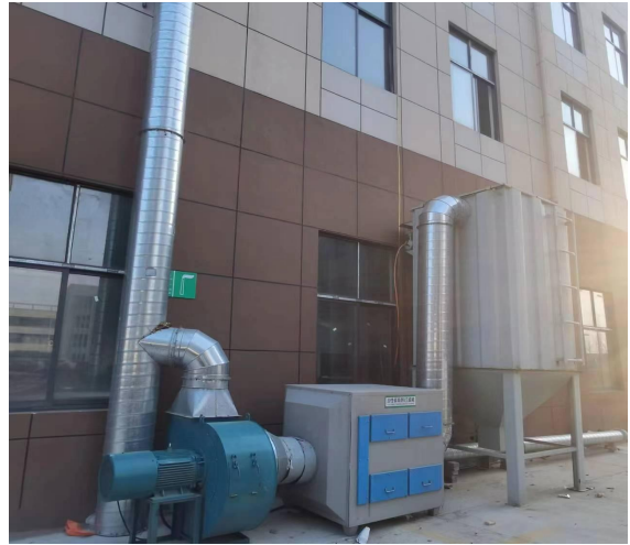
激光裁布工序废气处理装置
