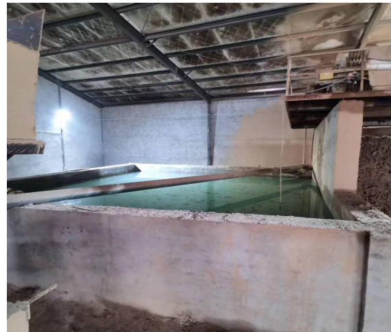
洗砂废水沉淀池
