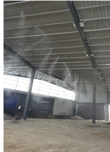
料仓喷雾设施
