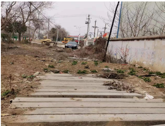
车辆冲洗废水沉淀池
