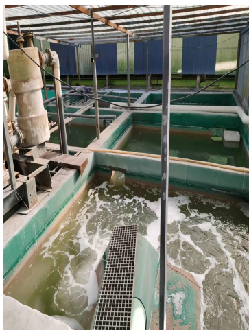
脱硫废水沉淀池
