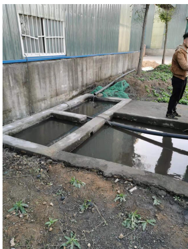
车辆清洗废水三级沉淀池
